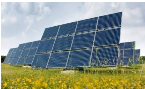
Planta de energía propia
