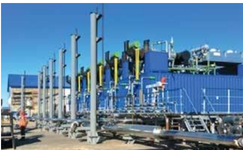
Planta de energía propia
